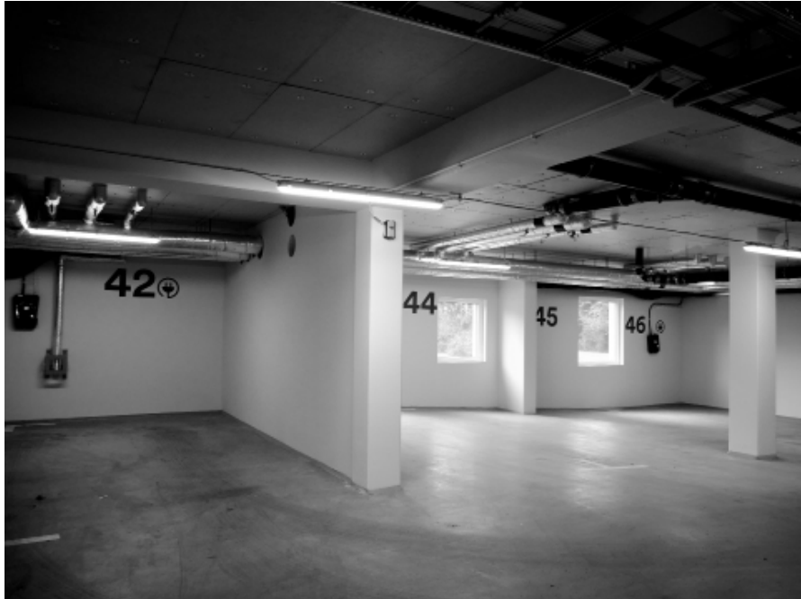
Garage med laddningsmöjligheter, Vårbergstoppen, Vårberg
