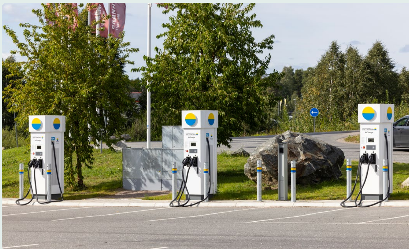
Laddstation vid Majoren 1, Falun
